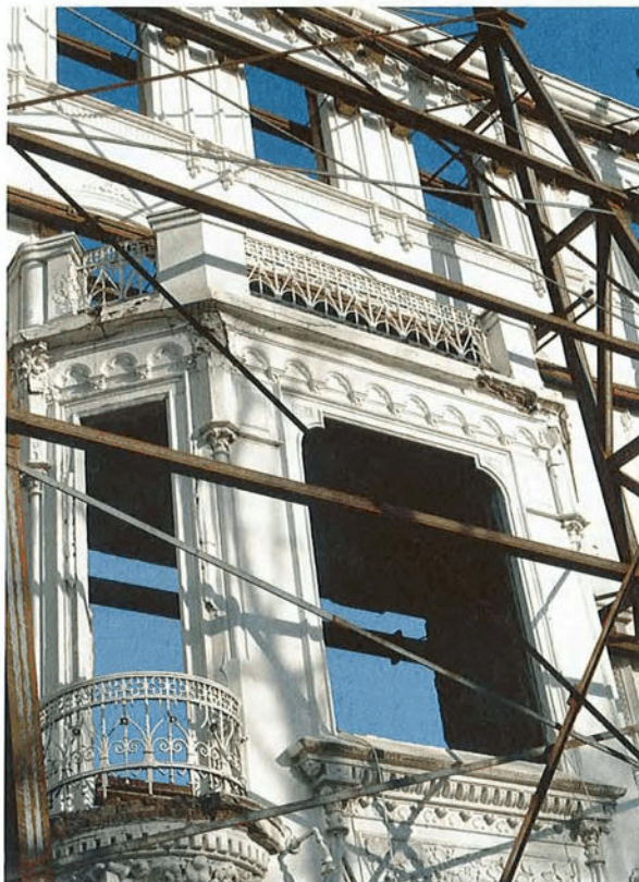
Manchmal wird bei der Sanierung denkmalgeschützter Häuser nur die Fassade stehengelassen. Dahinter entstehen komplett neue Wohnungen.
